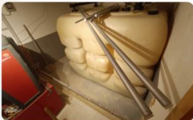
Vorher: Öltank im Keller
