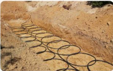
Ringgrabenkollektor in 2 m Tiefe
