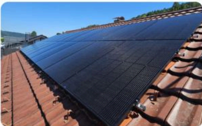
Fertige PVT-Anlage · 20 Module
