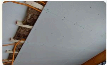
Deckenheizung im Aufbau
