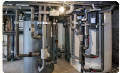
Pufferspeicher für Solarthermie
