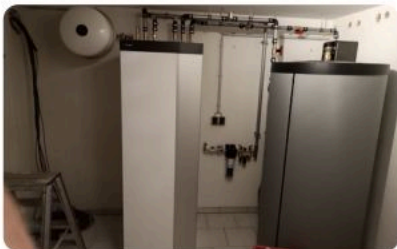
Nachher: WP mit Speicher
